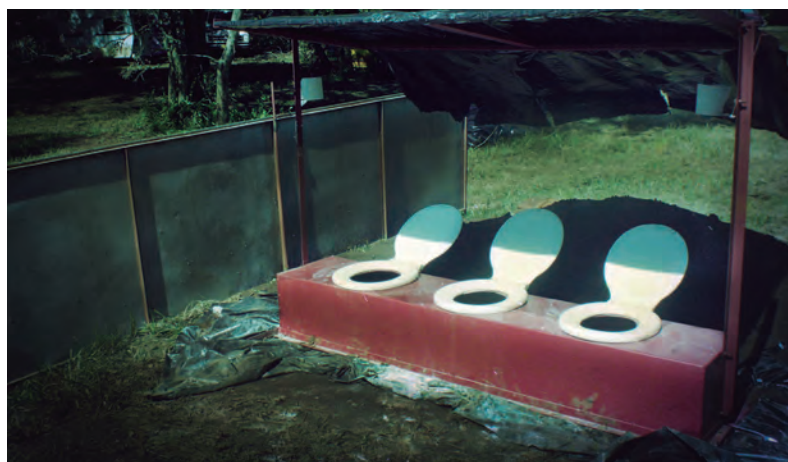
■ Instalações sanitárias do acampamento em 1996
